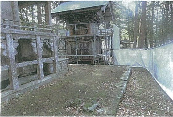
本殿外回りの工事 (格子塀を撤去し新たに設置、雨水排水工事)
